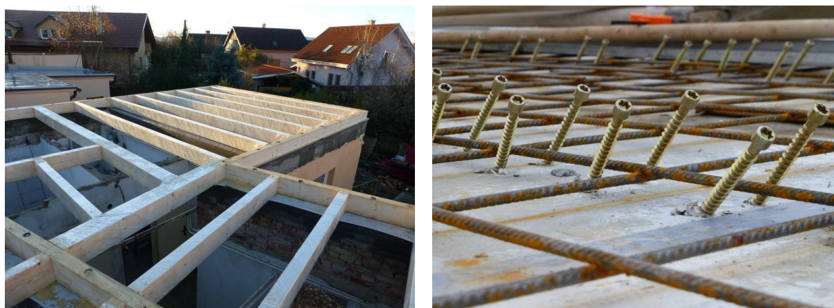
Obr. 4 - Pohľad na drevený trámový strop (vľavo) a detail osadenia spriahovacích skrutiek Würth (vpravo)
